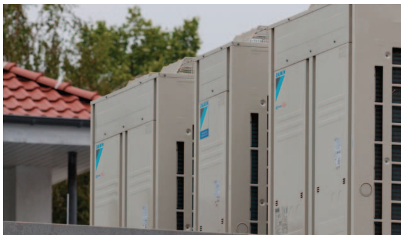
Edeka Buschkühle Вход Бад Валдлисборн; расположение Conveni-Pack
