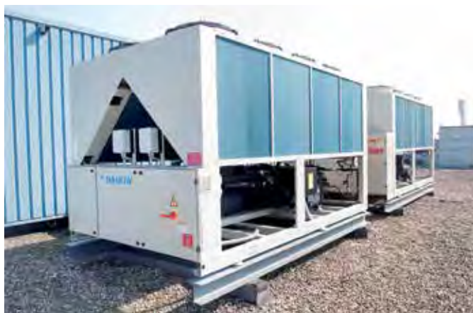
Встановлена холодильна машина з повітряним охолодженням конденсатора
