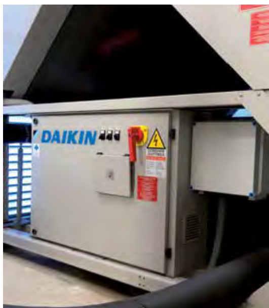
Встановлена холодильна машина з повітряним охолодженням конденсатора
