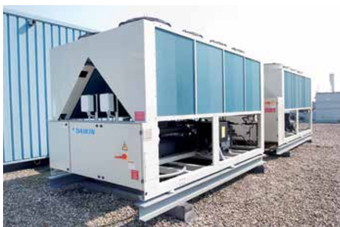
Встановлена холодильна машина з повітряним охолодженням конденсатора
